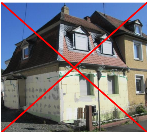
Unpassende Wärmedämmung an historischem Gebäude
