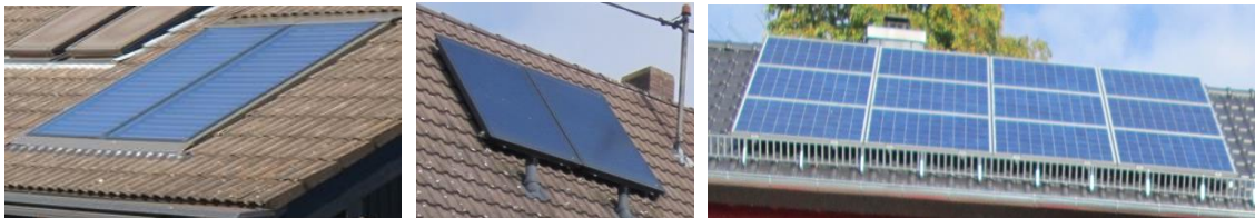
Sonnenkollektoren in .....und auf der Dachhaut
